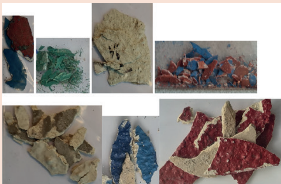
▲ Exemples d'écailles de revêtements prélevées sur ponts
