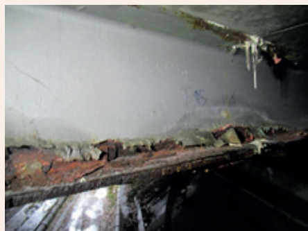
Délamination de peinture et corrosion sur une poutre d'un pont
