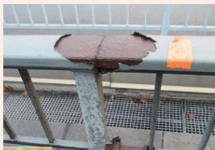
Délamination de peinture et corrosion d'un garde-corps d'un pont
