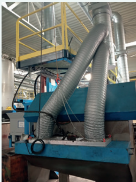
Systèmes de Ventilation et d'Aspiration : Images des systèmes de ventilation industrielle en place dans l'usine.
