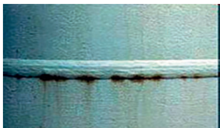
Fig. 6: corrosion intergranulaire dans la ZAT
