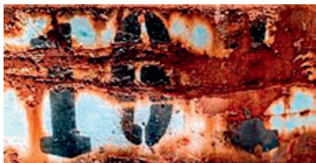
▲ Figure 1 - Exemple de surface corrodée
