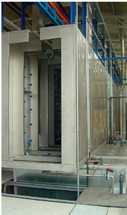
▲ Zicht op de sproeitunnel bij de klant
