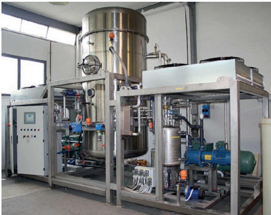
PHOTO 1 VN-T 10.000 verdamper verwerkt 10.000 liter afvalwater op 24 uur.
