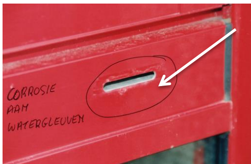
Foto: corrosie aan afwateringsgaten door het niet behandelen met een anti-corrosie product
