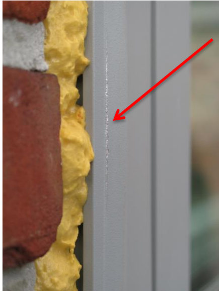
Foto: overbelast gepoedercoat aluminium profiel
