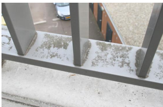
Foto 2: voorbeeld van een slecht onderhouden balustrade
