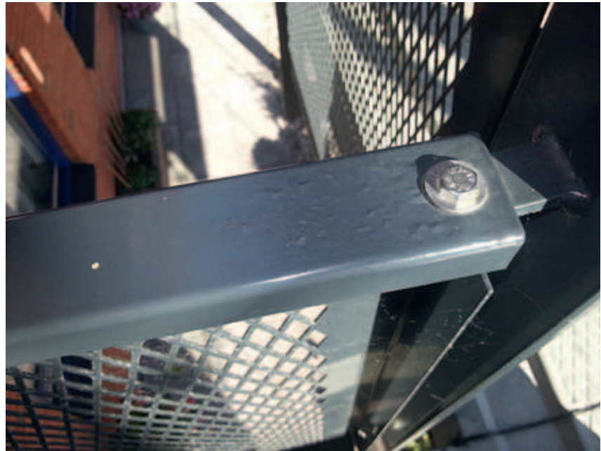
Figuur1 – corrosie door slechte voorbehandeling
