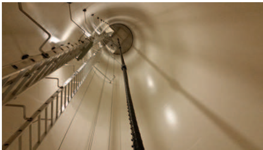
gecoate binnenzijde van een windturbine
