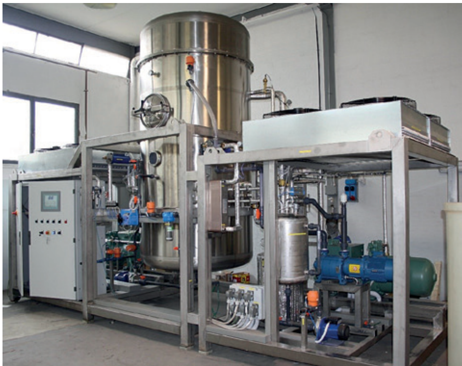
PHOTO 1 VN-T 10.000 verdamper verwerkt 10.000 liter afvalwater op 24 uur.
