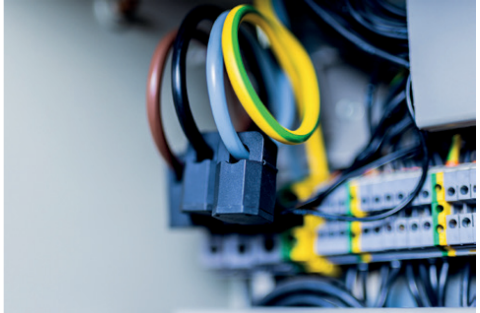
De sensoren van Sensorfact worden draadloos rond de drie-fase aansluiting geplaatst
