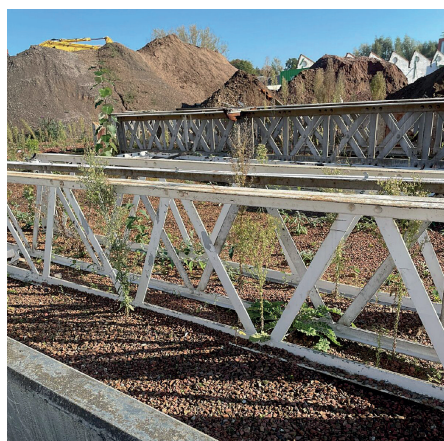
De vakwerkspan- ten vóór behandeling: de oude witte verflaag is duidelijk zichtbaar op de nog liggende constructies.
