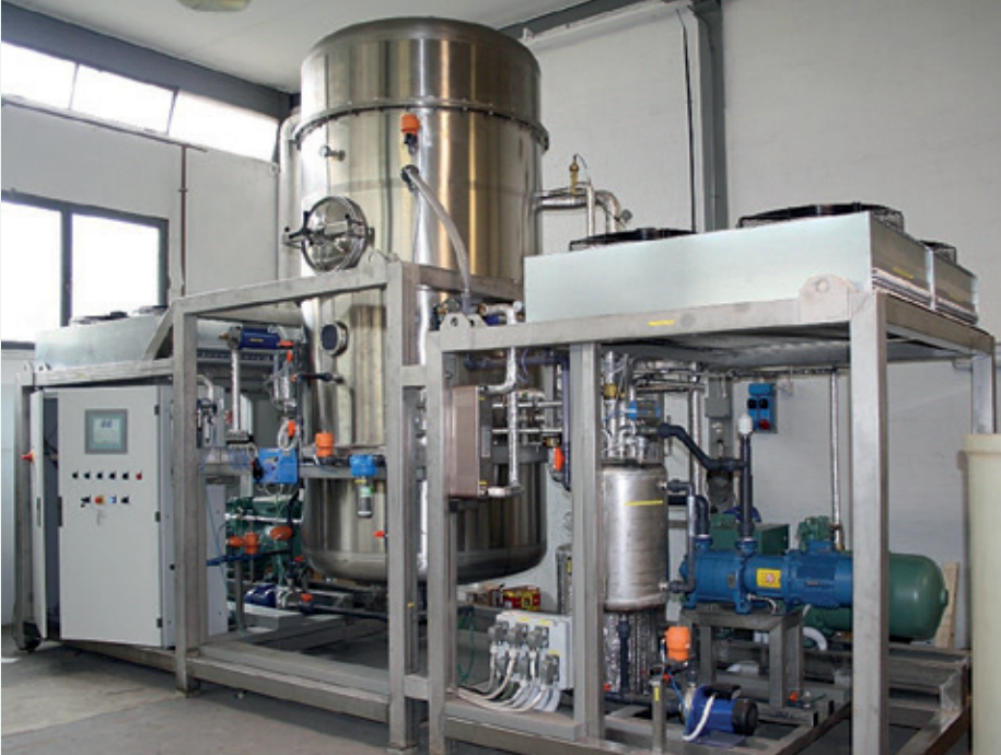
PHOTO 1 évaporateur VN-T 10 000 traite 10 000 litres d'eaux usées en 24 heures.
