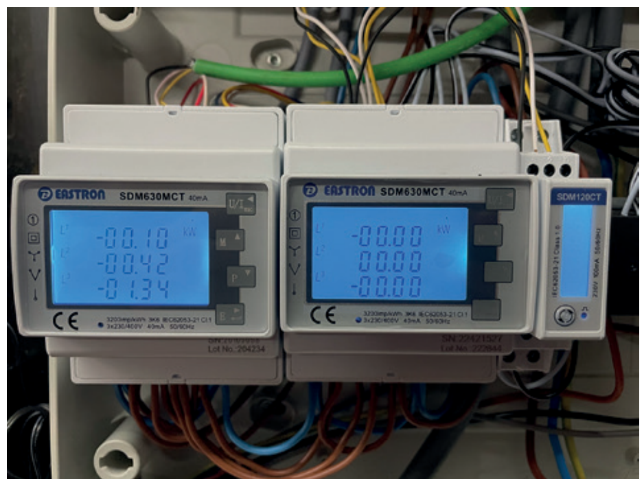
Figuur 1: Een voorbeeld van energiemeters ingebouwd in een verdeelbord
