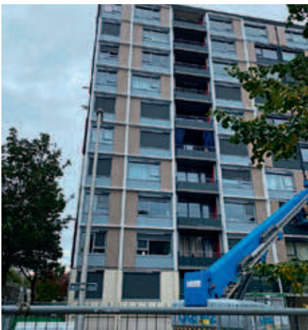
▲ project in Utrecht: aluminium gevelbekleding voorzien van chemische voorbehandeling volgens “seaside-class” gevolgd door polyestercoating met laagdikte 90 µm.
