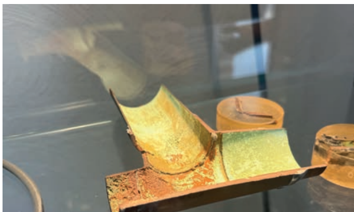
Cavitatie en spleetcorrosie van een gesoldeerde warmwaterleiding.
