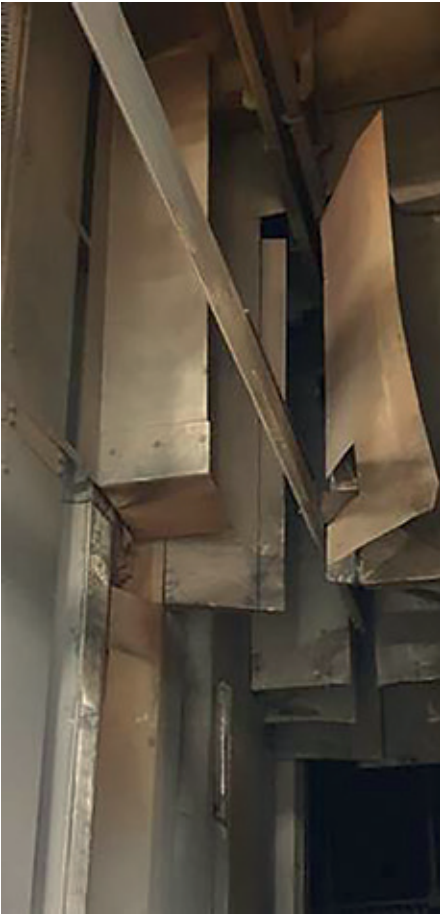
▲ Voorbeeld van moffeloven met beperkte aandacht voor onderhoud.
