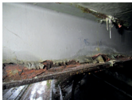
▲ Afbladeren van de verf en corrosie op een brugbalk
