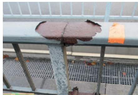
▲ Afbladeren van de verf en corrosie van een armleuning van een brug
