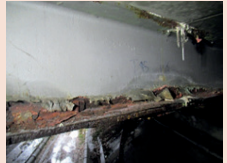
▲ Délamination de peinture et corrosion sur une poutre d'un pont
