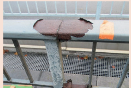
▲ Délamination de peinture et corrosion d'un garde-corps d'un pont
