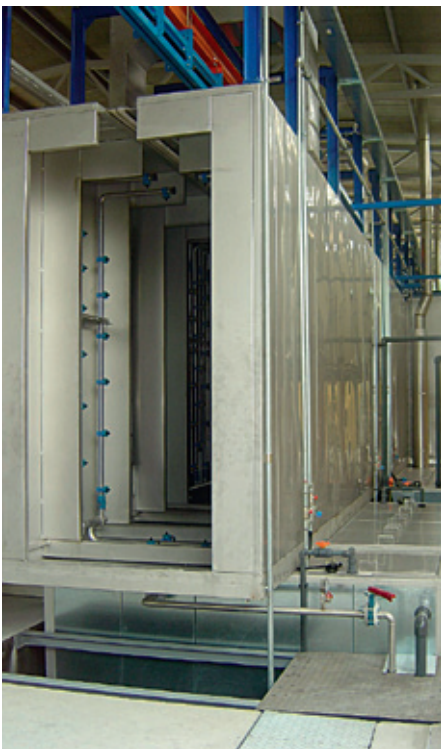
▲ Zicht op de sproeitunnel bij de klant
